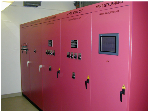
Steuerraum Tunnelzentrale Reussport Nord
