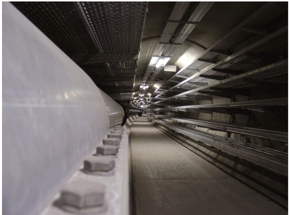
Wasserleitung im Werkleitungsstollen des Sonnenbergtunnels
