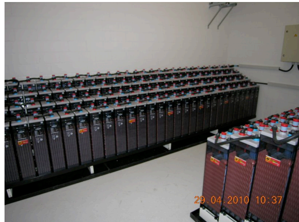
Batterien für Notfallstromversorgung Tunnelzentrale Lochhof
