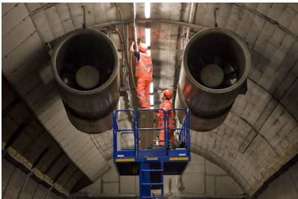
Strahlventilatoren im Sonnenbergtunnel
