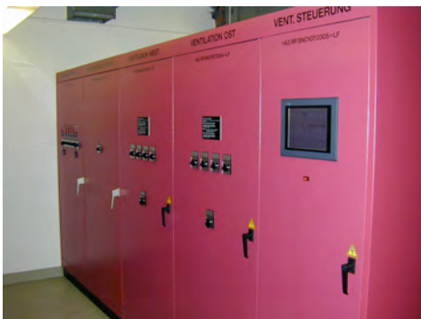
Steuerraum Tunnelzentrale Reussport Nord
