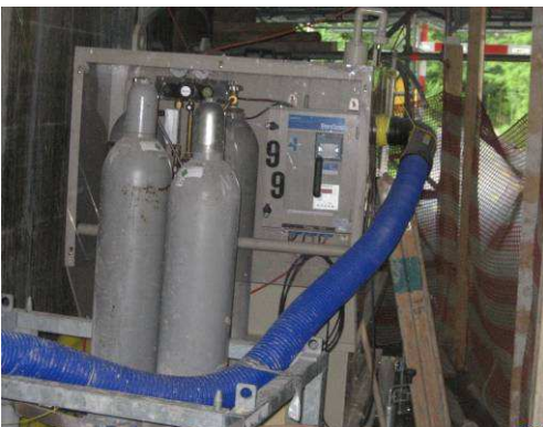
Abb. 3: Gewässerschutz wird gross geschrieben: Neutralisationsanlage für das Baustellenabwasser.
