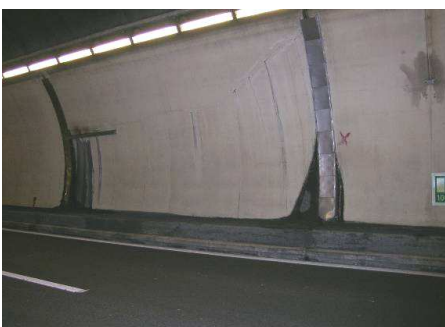
Abb. 3: Wassereintrittstellen bei den Gewölbefugen
