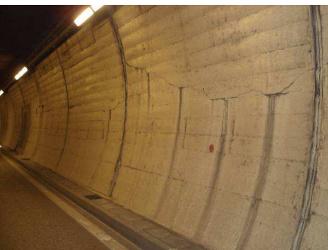
Abb. 3: Wasserführende Risse im Tunnelgewölbe
