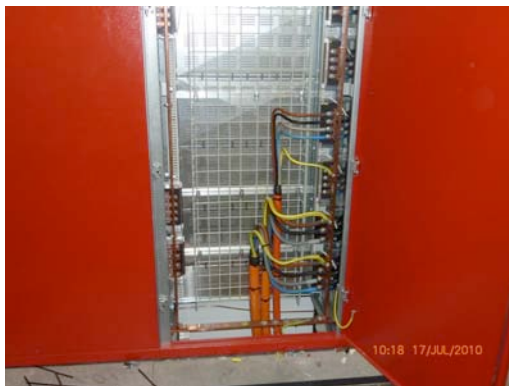
Anschluss Energieversorgung Tunnelzentrale Lochhof
